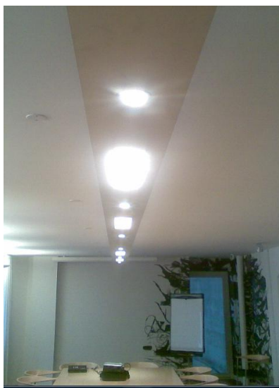
Halogen er en meget energiforbrugende lyskilde og det bør derfor undersøges om det er muligt at udskifte til en mere energirigtig lyskilde.
