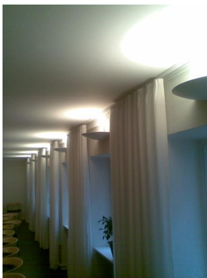
Mødelokale 140: Disse armaturer er meget energiforbrugende og bør tages ned.
